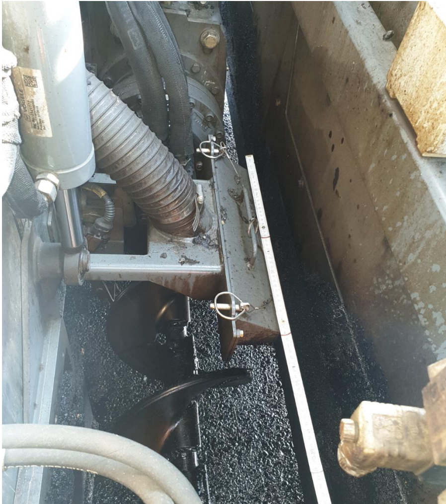
Abbildung 3: Absaugung an der Bohle eines Asphaltfertigers [16]
